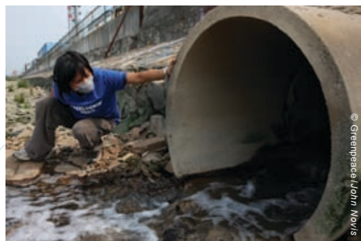
工业区围墙外的排污管
