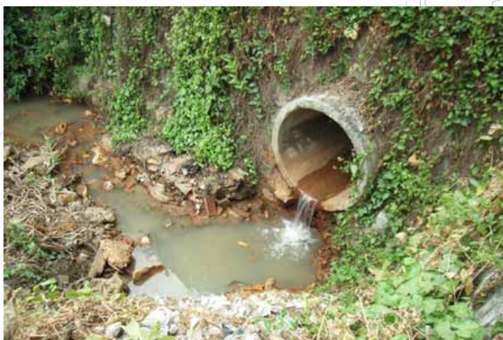
综合排污管的污水最终流入同沙水库
