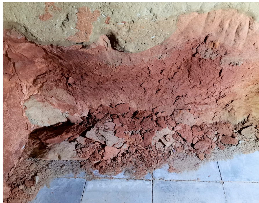
图 17 金塔寺东窟西北角窟壁下部岩体剥落（张掖市文物保护研究所供图）
